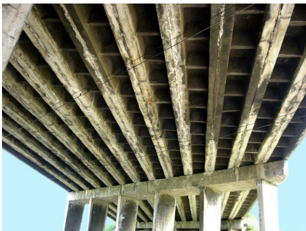
Obr. 2 Poškodené nosníky pôvodného mosta
